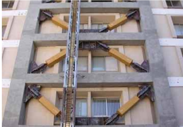
شکل ۶- استفاده از BRB مقاوم‌سازی
